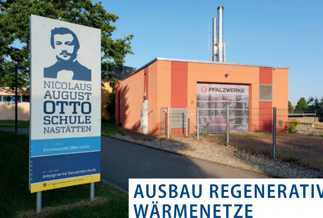
Das Nahwärmekraftwerk in Nastätten (Taunus) versorgt die umliegenden Schulen und Kitas.
